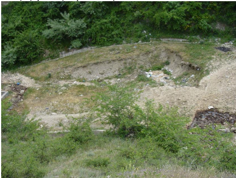
Фотографија 5-1 Ерозија на потпорниот насип
