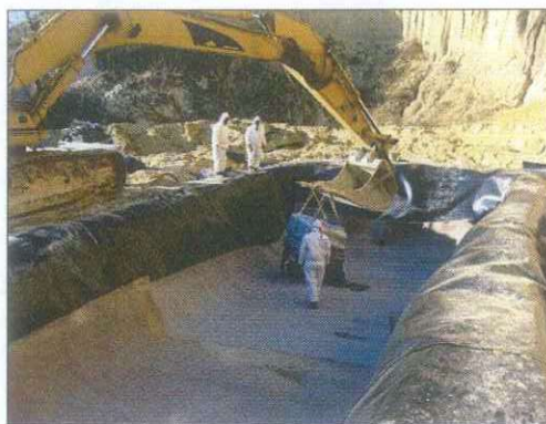
Слика 10: Депонирање на азбест
