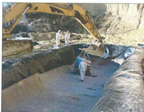
Слика 10: Депонирање на азбест
